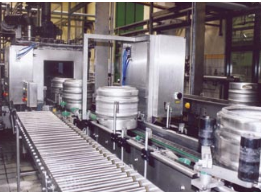
Im Anschluss an Kappenabzieher und Kappenprüfer geht es zur Außenreinigung der Kegs im Innokeg Till AK 4/1.
